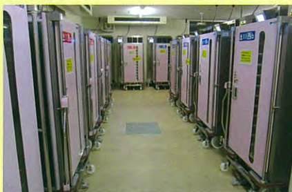
夜間無人運転中の再加熱カート（冷蔵運転中）
